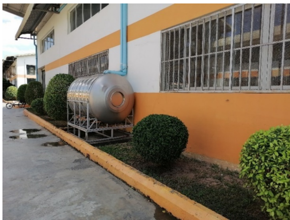
【廁所沖洗水使用再生水】
